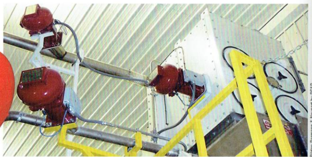
Das System kann in jeder beliebigen Lage eingebaut werden und eignet sich auch für ungünstige Platzverhältnisse. Die beiden Entkopplungssysteme links im Bild verhindern, dass eine Flammenfront sich im Rohrsystem ausbreitet. Das dritte, baugleiche Teil rechts erstickt – als Unterdrückungssystem verbaut – eine mögliche Explosion im Prozessbehälter bereits in der Entstehung (rechts).
